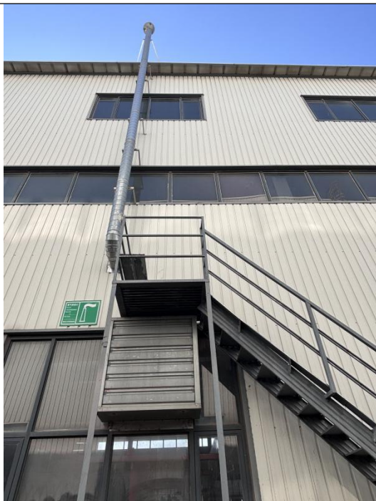
现有 P3 排气筒及标识牌
