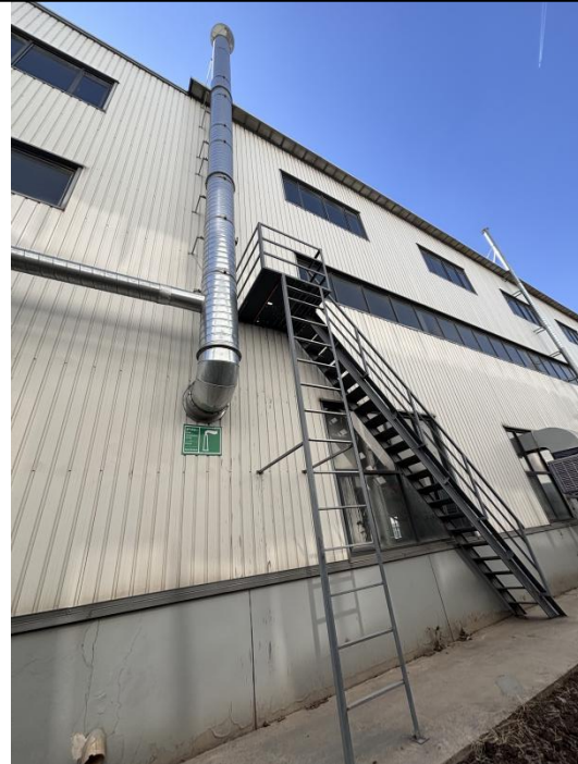
现有 P2 排气筒及标识牌
