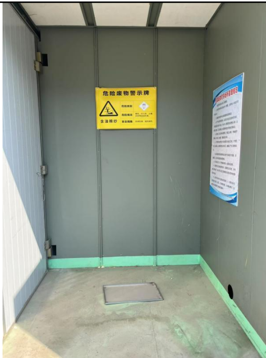
危废暂存间内部照片
