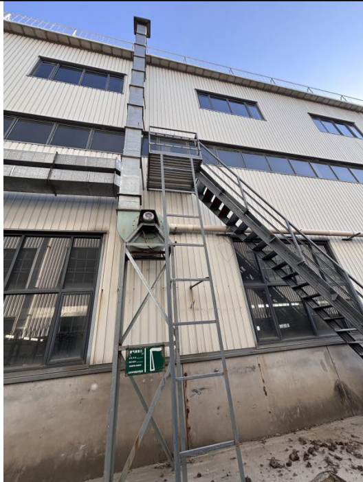
现有 P1 排气筒及标识牌
