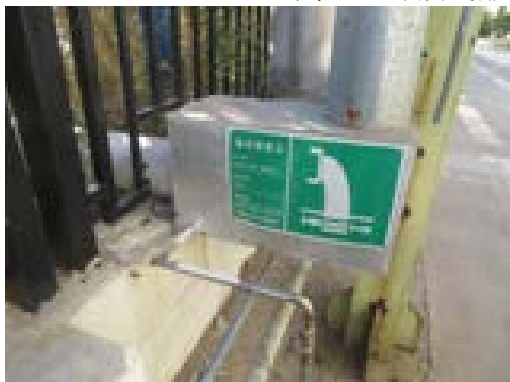
污水总排口 W1 及标识
