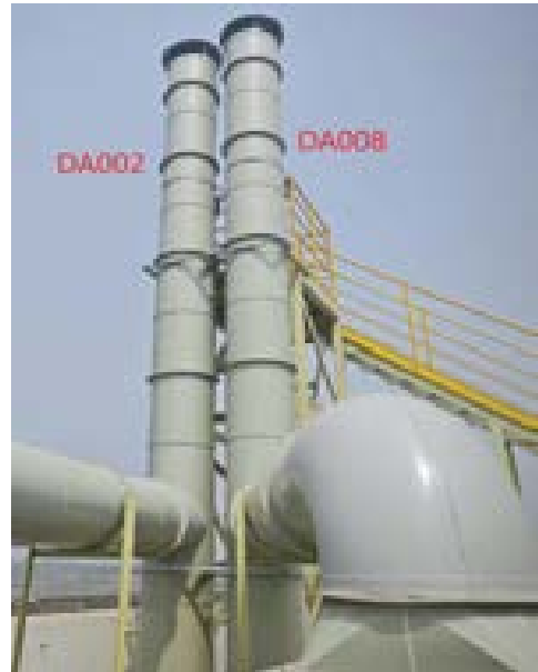
品管实验室排气筒 P6 (左)
