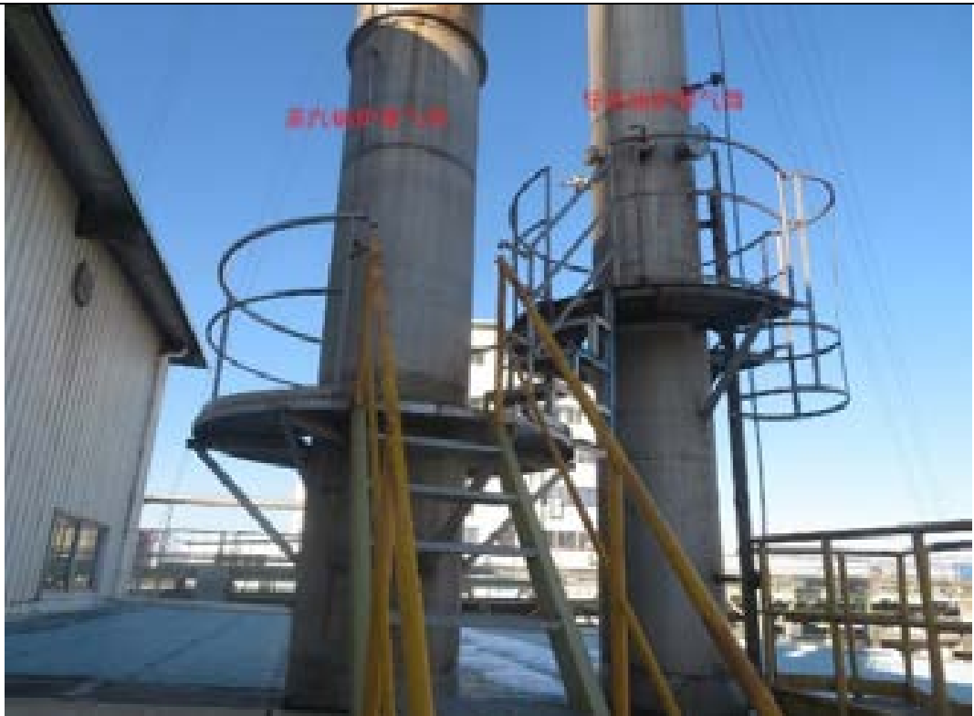
导热油炉排气筒 P1（右）及燃气锅炉排气筒 P5（左）
