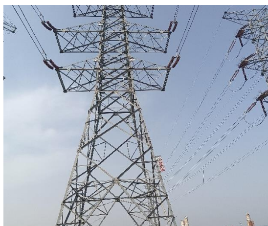
千米桥 220kV 变电站北侧的现状塔
