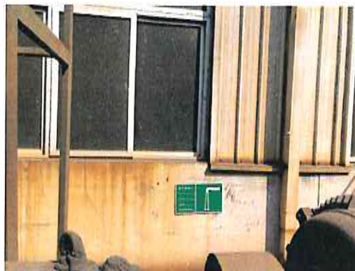
排气筒 FQ-089-17 标志牌
