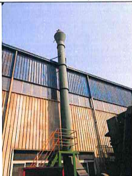
厚板预处理车间排气筒 FQ-089-16
