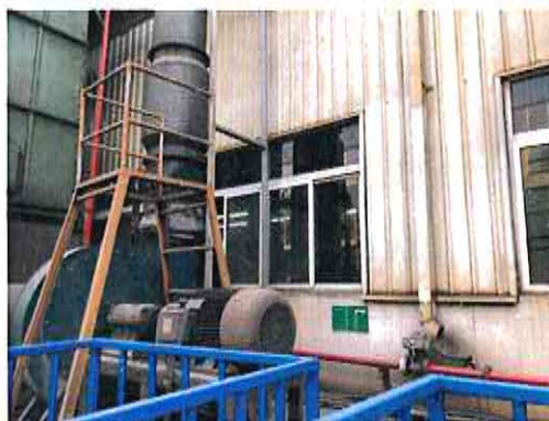
排气筒 FQ-089-15 标志牌
