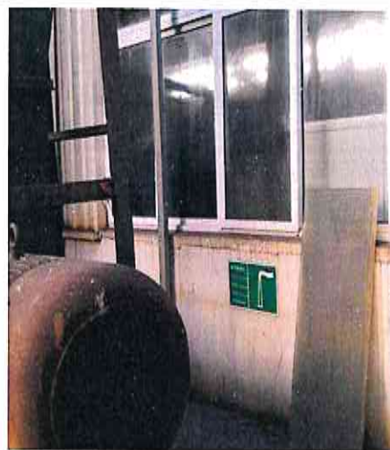
排气筒 FQ-089-20 标志牌
