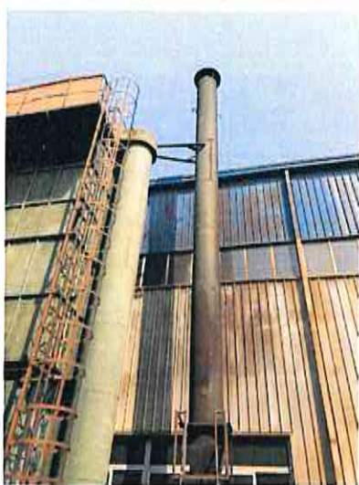
厚板预处理车间排气筒 FQ-089-17
