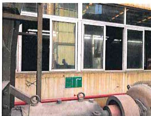
排气筒 FQ-089-18 标志牌
