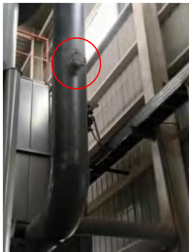
破碎工序自带除尘器进口采样孔
