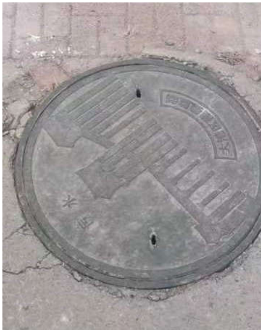
医院正面店门口污水独立总排口
