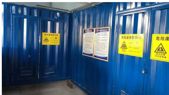
危险废物暂存间
